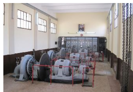
Equipement électrique au niveau de la microcentrale de Fillo
