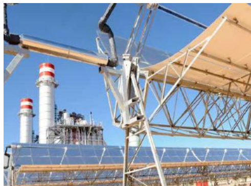
Centrale thermo-solaire d'Ain Beni Mathar
