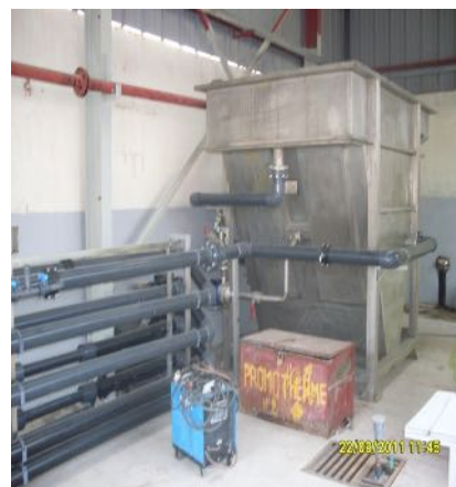
Station d'épuration des eaux usées de Sifitex
